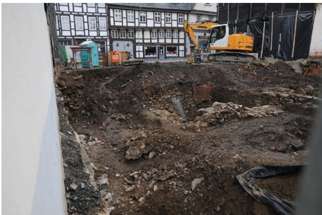
Grabung Brandruine Petersilienstraße 35. Mauerzüge aus mittelalterlicher oder früherer Zeit konnten nicht nachgewiesen werden.
