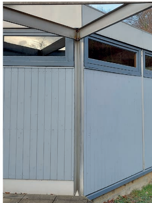
Freibad Liebenburg. Linkes Bild: Ablesbarkeit des Trelementsystems durch freistehende Konstruktionselemente. Rechtes Bild: Sternstütze ohne Wärmedämmung – Kältebrücke führt bei unterschiedlichen Innen-Außentemperaturen zu Tauwasserbildung auf der Innenseite. Dieser Mangel ist bei den folgenden Gebäuden durch eine Wärmedämmung der Profilaußenseiten abgestellt worden. Bei dem Trelement-Pavillon der Schillerschule in Goslar, Hoher Brink, ist die später verbaute Stützenverkleidung mit innenliegender Wärmedämmung zu erkennen (S. 9).
