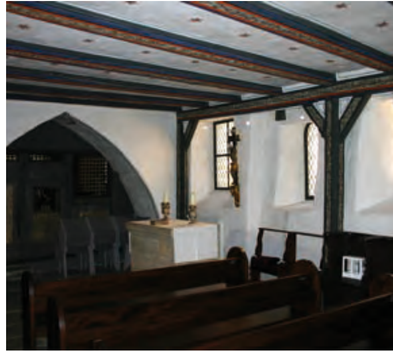
Abb. 88: Erdgeschoss der Kapelle innerhalb der Kemenate. In der Nordwand befindet sich eine über den gesamten Wandabschnitt reichende Spitzbogenöffnung. Sie stammt aus der Bauzeit des Spitals (ab 1254).
