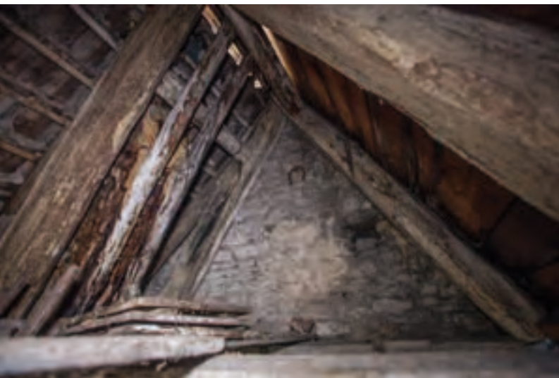
Abb. 224: Auch die Kehlbalken und Sparren unmittelbar vor dem Nordgiebel des Hauses weisen Blattsassen für den Anschluss senkrechter Hölzer auf.
