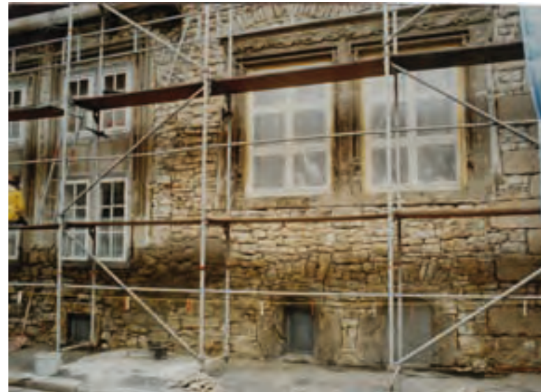
Abb. 180: Putzfreilegung der Straßenfassade während der Sanierungsarbeiten 1986. Die Aufnahme zeigt den Bereich der Kemenate im Übergang zum Dielenteil.
