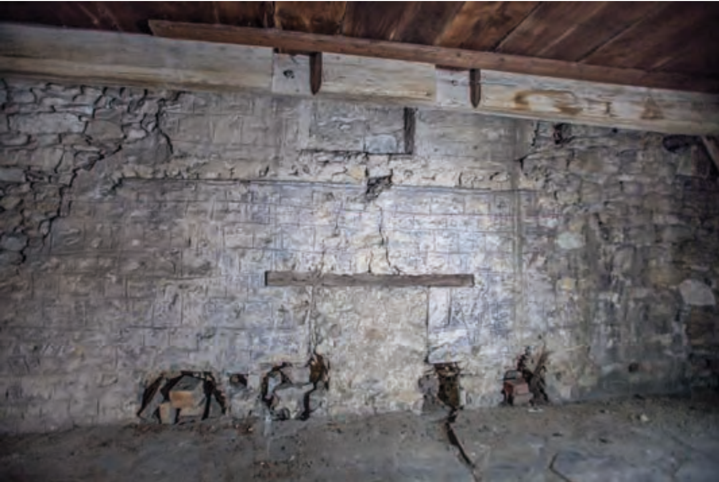
Abb. 221: Am Nordgiebel zeichnet sich der Umriss eines ursprünglich niedrigeren Giebels mit vorgetäuschten Fugenstrichen und älteren, nun vermauerten Fensteröffnungen ab. Auch der Abdruck des ursprünglichen Kehlbalkens ist sichtbar.
